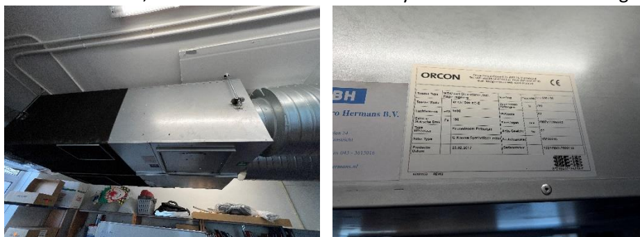
Foto 4 en foto 5. Ventilatiesysteem bibliotheek met WTW.
