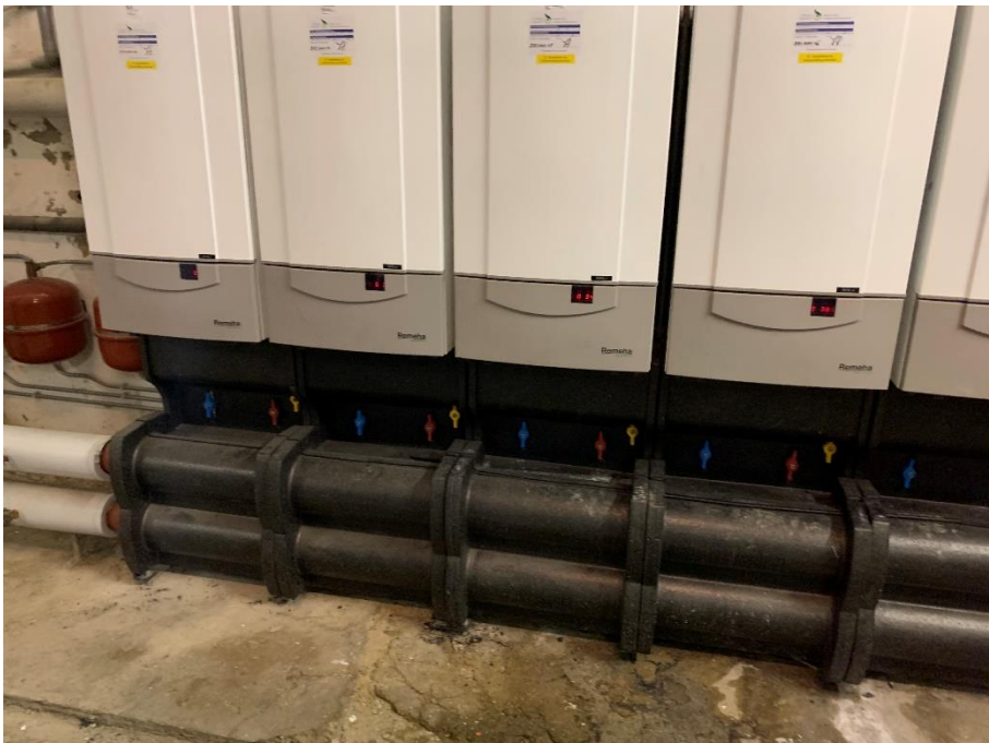
Geïsoleerde leidingen van de HR 107 ketels.
